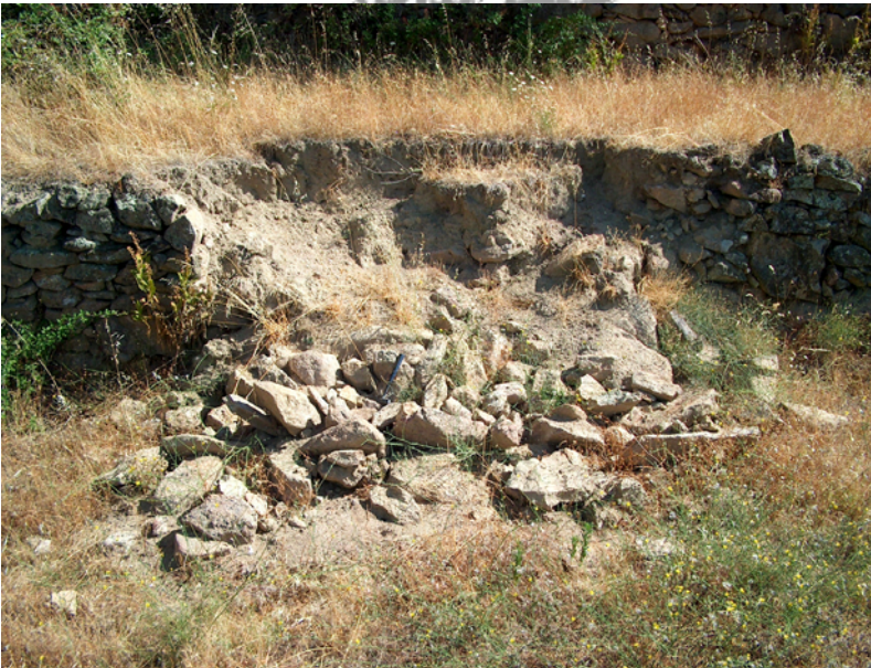
Derrumbe de las paredes de un bancale sin uso agrícola.
